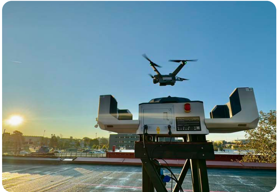
Med droner kan vi få et raskere overblikk over et innsatsområde. Drone-i-boks er plassert på taket på brannstasjonen i Kristiansand. Foto: Anders Martinsen
